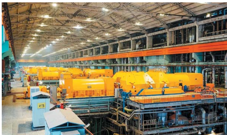
РИС. 1. ► Энергоцех Кармановской ГРЭС
